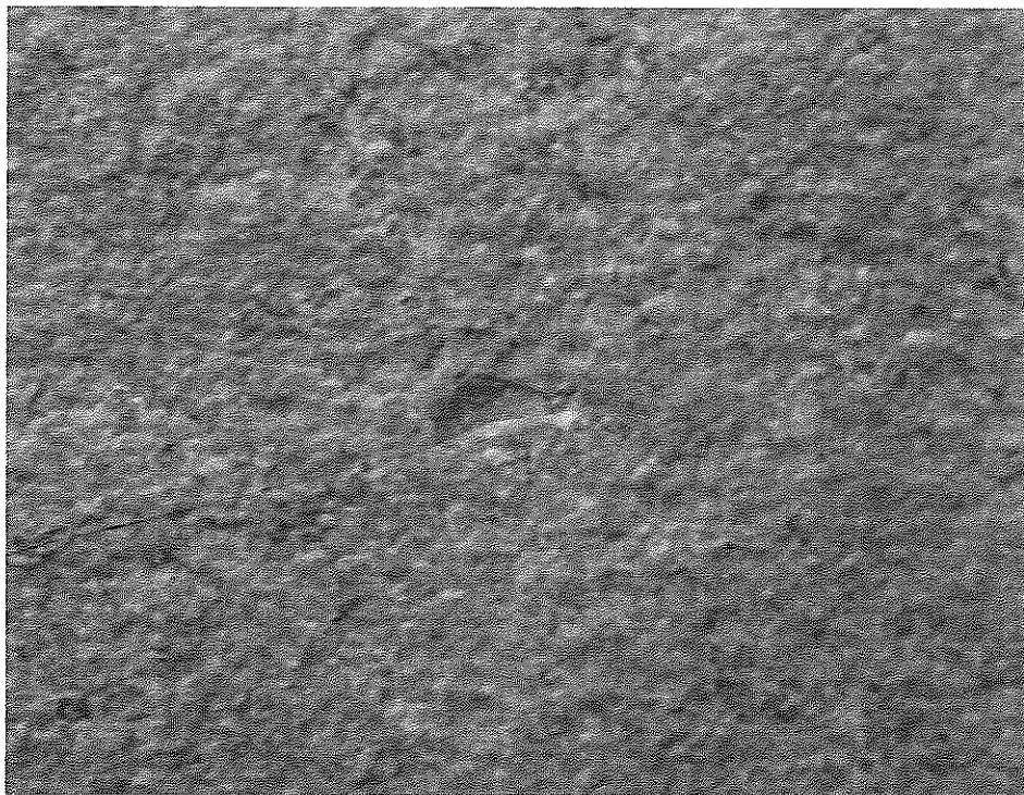
Particolare del campione dopo urto da corpo duro al centro della lastra.
